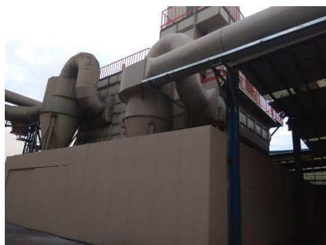
布袋除尘器（铝灰处理系统配套除尘器）
