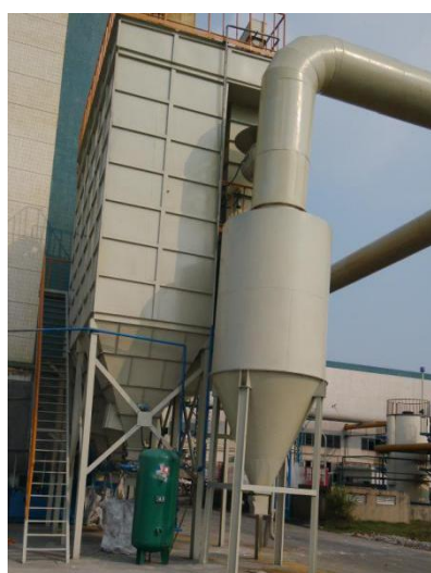
二期 1#炉组配套布袋除尘器
