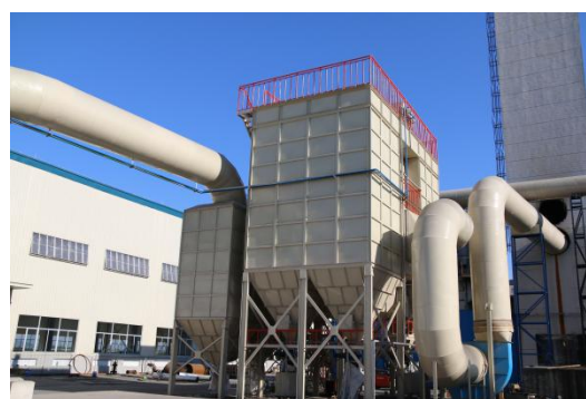
二期 2#炉组配套布袋除尘器
